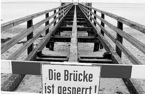
Gesperrt: Der Schiffsbohrwurm hat die Holzpfiler der Brückenkonstruktion zerstört.
