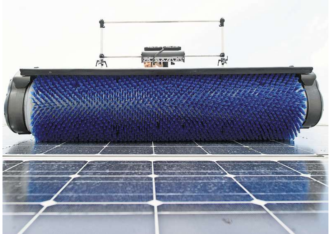
Die Wartung und Reinigungsarbeiten von Solaranlagen sollten Profis übernehmen.
