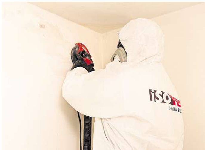
Die Schimmelpilzbeseitigung sollte einem Profi überlassen werden. Foto: hfr
